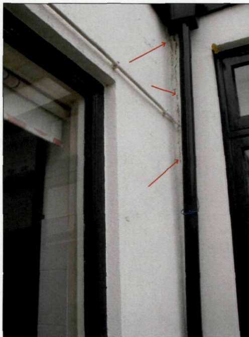
Foto 10: Scheurvorming aansluiting achtergevel-uitbouw nr. 42.
