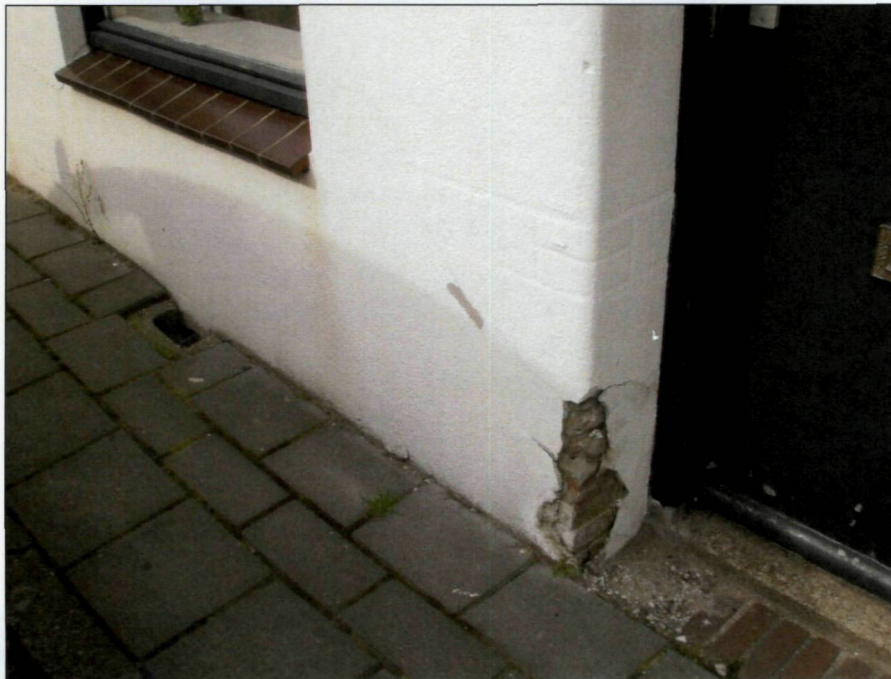
Foto 4: Losgekomen stucwerk nabij de voordeur van nr. 42.
