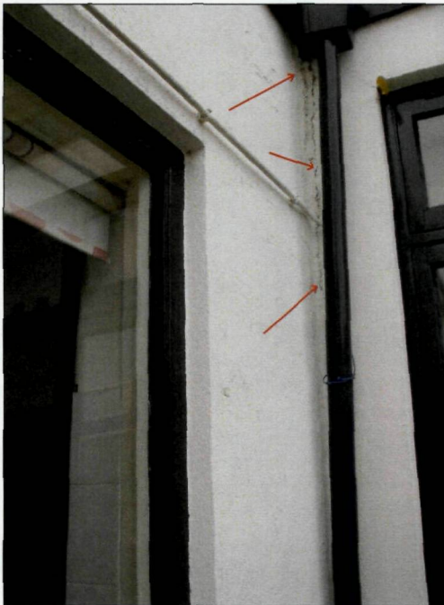
Foto 10: Scheurvorming aansluiting achtergevel-uitbouw nr. 42.
