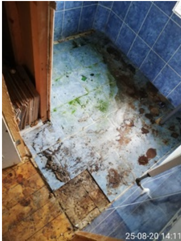
foto 5 deel vloer badkamer en overloop van de eerste verdieping.
