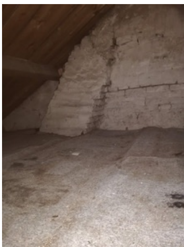
foto 4 deel vloer vliering en woningscheidende wand vliering.
