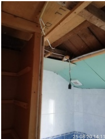
foto 6 deel wand en plafond badkamer van de eerste verdieping.
