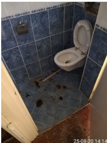
foto 10 deel van de vloer en wanden van de toilet en hal.
