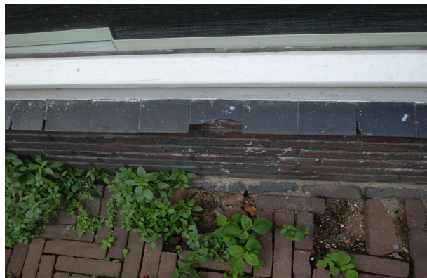
02 Enkele tegels zijn stukgeraakt en de voegjes tussen de tegels zijn plaatselijk weggevallen. (1.4)
