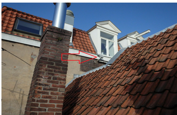
05 De vergaarbak is losgeraakt en het horizontale deel van de afvoer is verstopt. Het water klettert nu op de onder gelegen dakkapel. (2.4.2)
