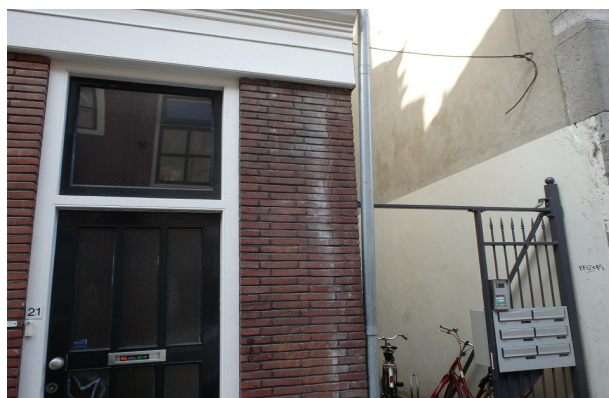
04 Aan de onderzijde van de afvoer zijn geen beugels aanwezig. Nu hangt de afvoer los en kan deze t.p.v. de bochten uit de verbinding raken. (2.4.2)
