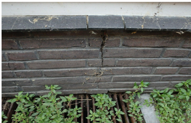
01 Op de begane grond aan de voorzijde onder het grote raam zijn enkele scheuren aanwezig. Deze scheuren worden veroorzaakt door het oproesten van een ijzeren latei (profiel) die in het metselwerk aanwezig is. (1.2.1)
