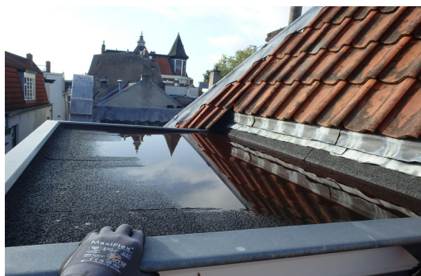
06 Op het dak blijft aan een zijde veel water staan. Tijdens hevige regen is het mogelijk dat water naar binnen kan lopen. (2.5.1)
